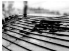
写真A.8 屋根の被災状況
