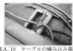
写真A.10 ケーブルの噛み込み箇所
