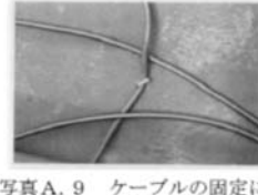
写真A.9 ケーブルの固定に伴う噛み込み箇所
