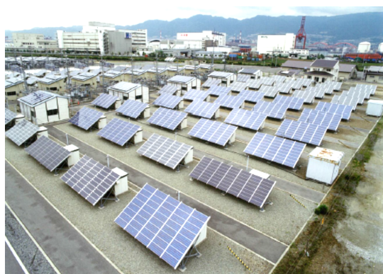
図3 200kW 太陽光発電配電線連系実験設備 （関西電力（株）六甲アイランド実験場）
