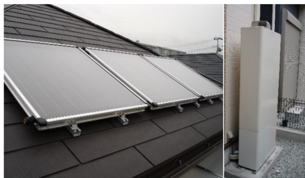
図 1(b) ソーラーシステムの写真
