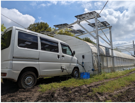
自家消費用の太陽光発電設備と電気自動車
