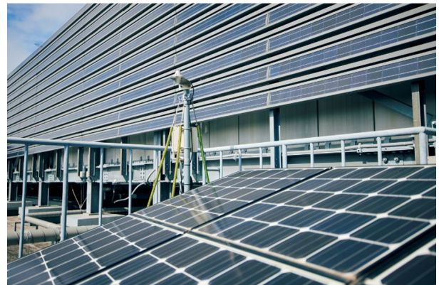
図 葛飾キャンパスの研究棟屋上に設置している実験用の太陽電池アレイ
