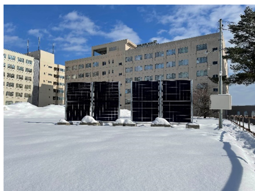
図4 大学に設置した垂直両面受光太陽電池
