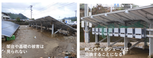
図14 河川氾濫による被害
