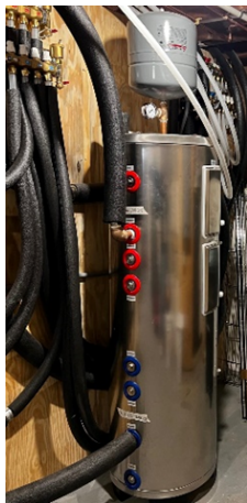
写真6 新しい Air to Water ヒートポンプとタンク
