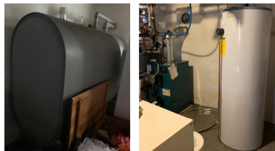
写真5 既存の暖房・給湯設備
