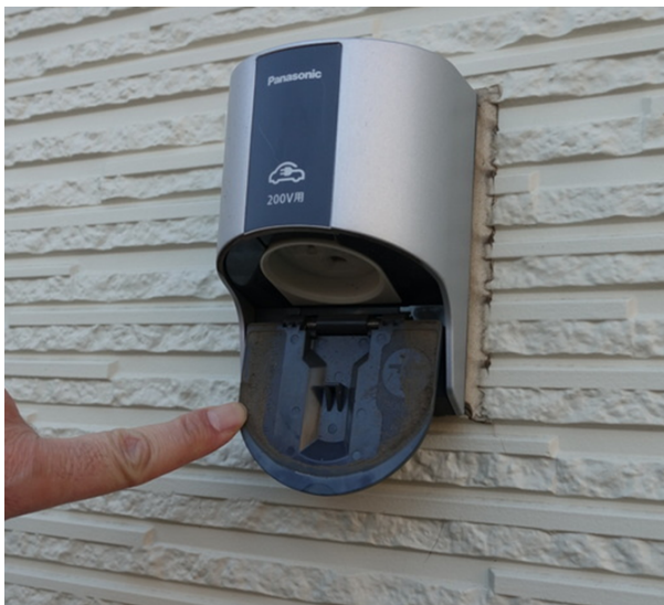
図5 EV用コンセントの例（200V 20A）
