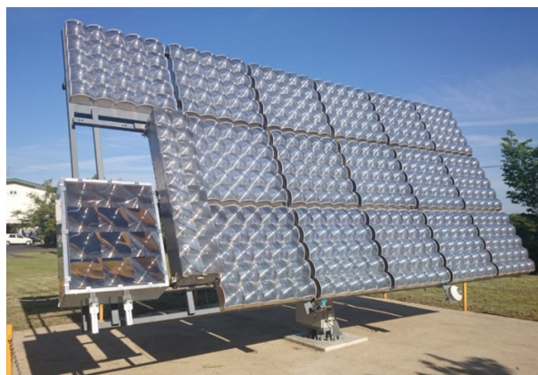
写真3 津山高専に設置されている集光式太陽光発電システム。
