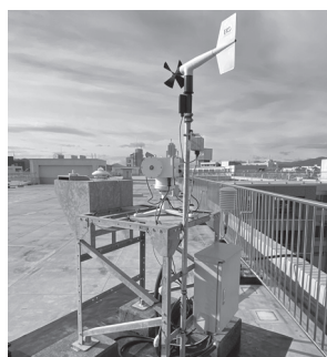
図4 日射計や魚眼カメラなどが設置された気象観測装置
