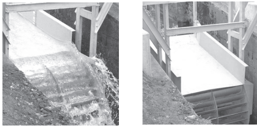
図3 移動式導水路 (左：稼働状態, 右：退避状態)
