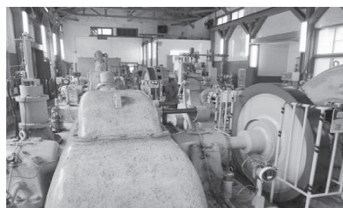
写真2 白田川発電所水車発電機（改修前）
