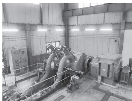
写真3 白田川発電所水車発電機（改修後）
