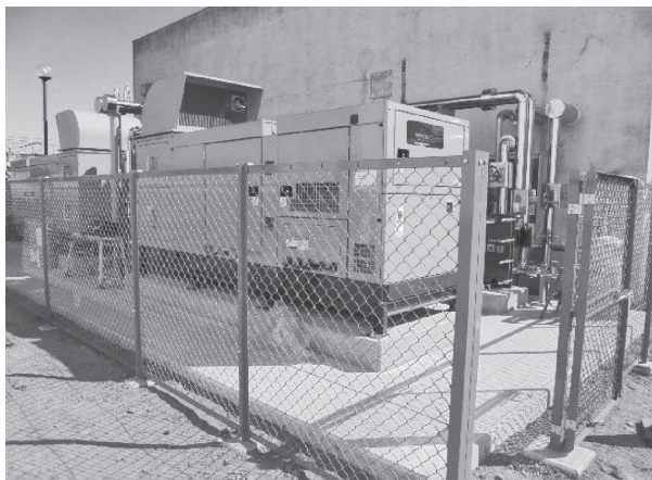
写真1 消化ガス発電機外観
