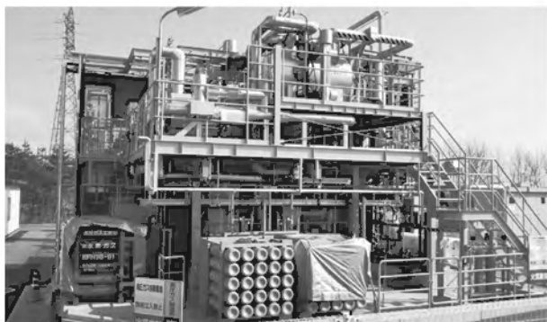
図7 アンモニア合成実証試験装置外観
