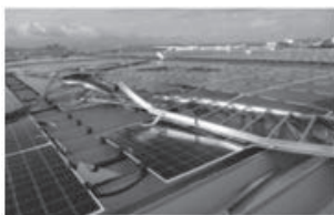
(写真: 台風21号による倒壊)
