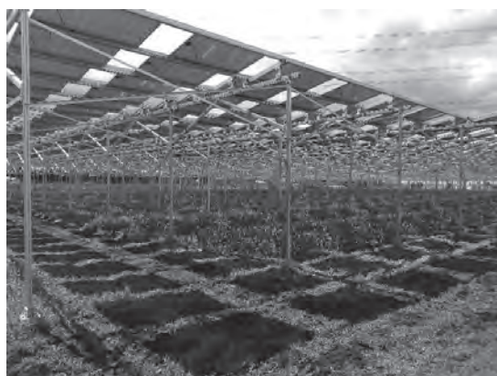
写真 3 藤棚式の営農型太陽光発電設備
