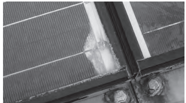
写真 1 端部から水分が浸入した痕跡が認められた太陽電池モジュール
