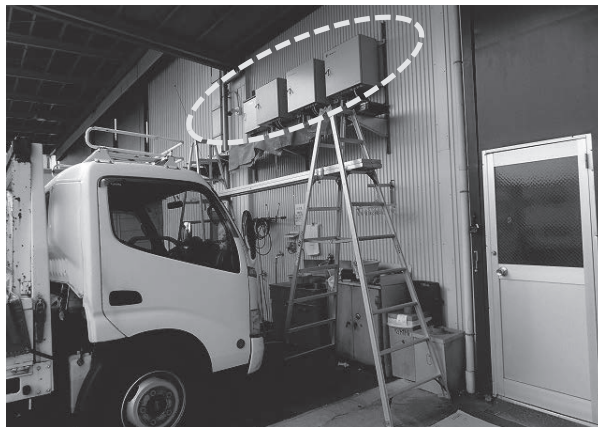
写真2 産業用 PVS (点検箱が接続箱内蔵型 PCS)
