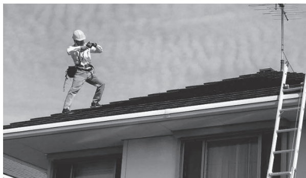
写真3 墜落防止措置をしていない屋根上の PVS 点検業者
