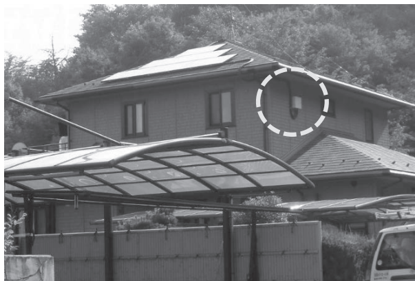
写真1 住宅用 PVS (点検箱が接続箱)
