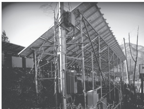
図 6 整地をせずに設置された PVS の例 (50kW 未満 2 件の分割案件。土地を整地せず、交差点の際まで架台を張り出して設置している。)
