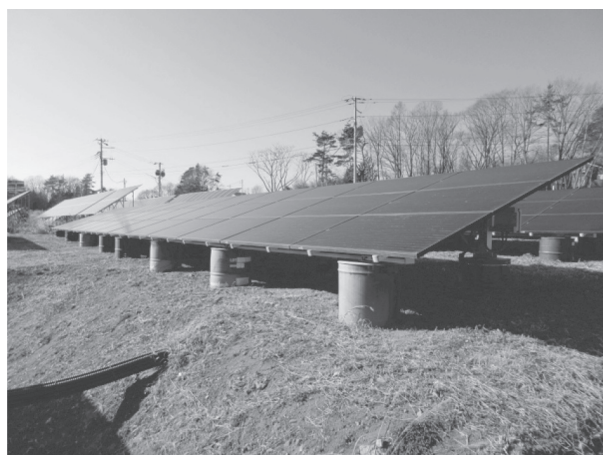
図7 ドラム缶を架台に利用して設置されたPVSの例 (50kW未満。濃縮果汁のラベルのついた使用済ドラム缶を架台として設置している。)
