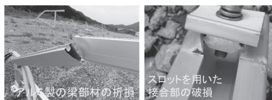
図2 アルミ製架台の被害事例
