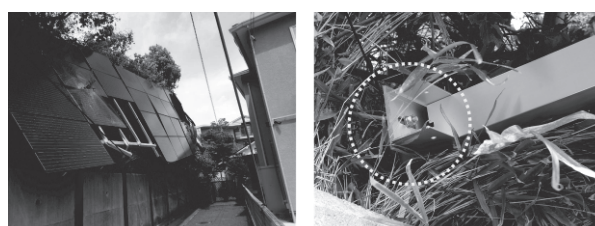
図6 建物上設置PVの被害
