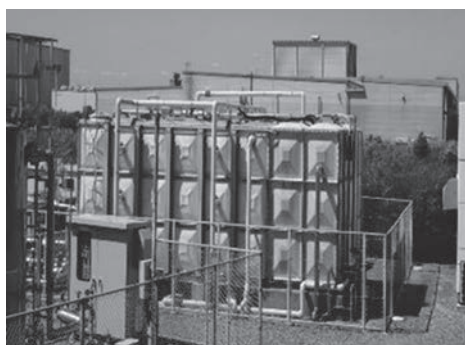
図 12 75t 電気温水タンク
