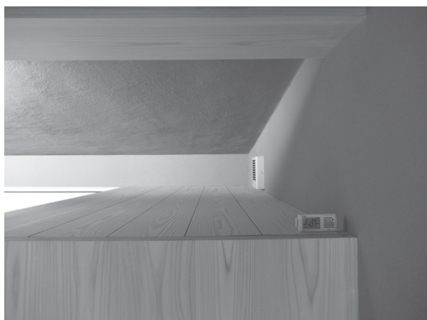
写真8 土パッシブ暖房吹き出し口
