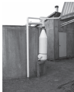
図8 雨水タンク (左) と木の葉等の除水器
