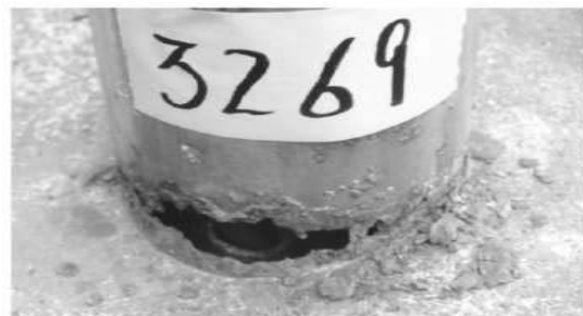
地際部が錆び、孔が開いた状態
