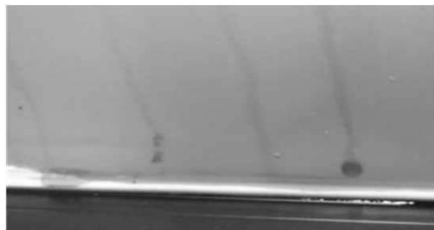
ケーブル可塑剤のブリードアウト、外装の変色、外装の収縮は全数に見られた。
