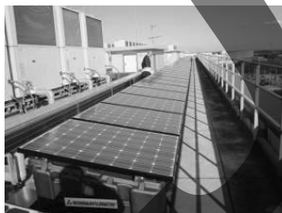
PVシステム
