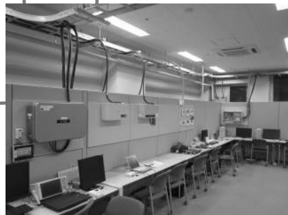
監視・制御システム
