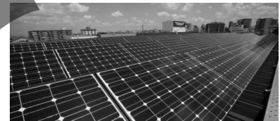
120kW設備 (屋根上設置)
