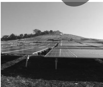
山の斜面に設置された太陽光パネル
