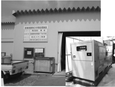
バイオガス・コージェネレーション施設
