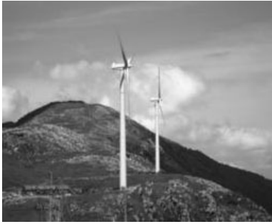
高原に設置された風車
