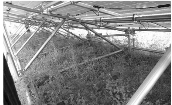
雑草。隙間の大きさにより除草が困難になる場合がある。
