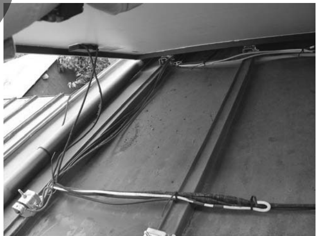
ケーブル接触面に砂埃滞留
