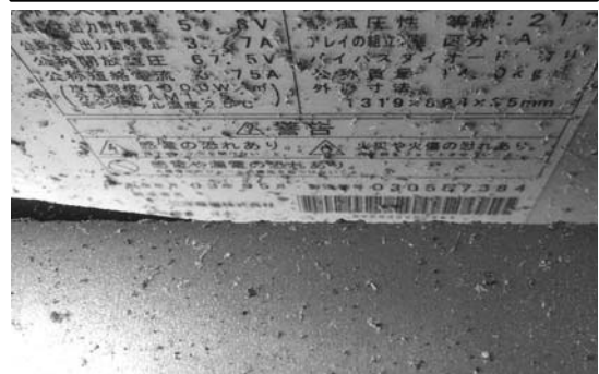
架台、電池裏面の汚れ付着状況
