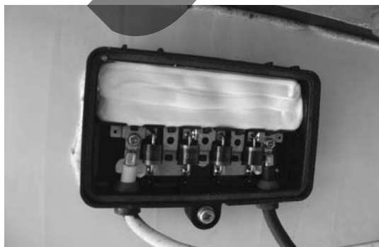
端子箱内、充電部露出状況
