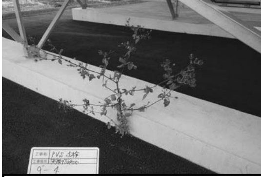
基礎と舗装の隙間から生えた草
