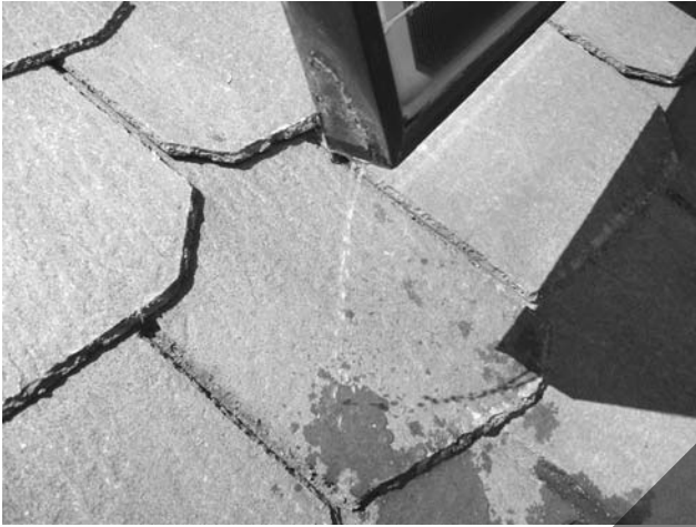
太陽電池モジュール内の水
