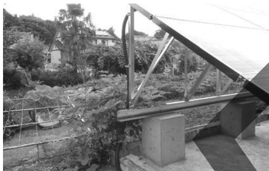
未対策隣地より草木が浸食
