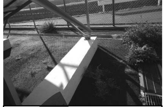
舗装を突き破り生えた草
