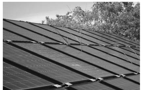
現在、枝に葉はないがガラス破損
