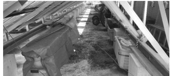
農機具、資材。日常的に利用して いるので今後可燃物が増加する 可能性が高い。注意喚起する。
