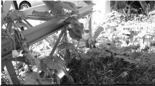
つる草。早めに除草しないと架台やケーブルに巻き付き草刈時にケーブル切断の可能性がある。
