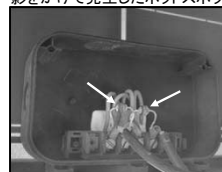
PVモジュールに付いているBPD
