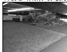
PVモジュールと屋根の間の鳥の巣 (※3)
