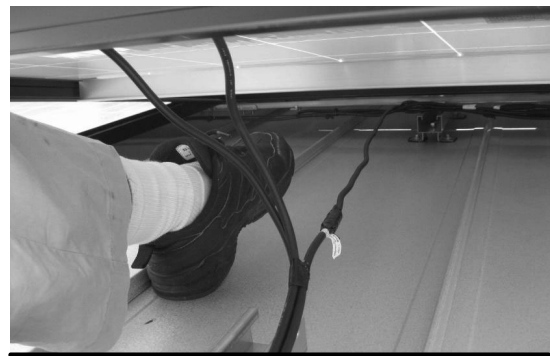
屋根置き設置型(傾斜板金屋根)
