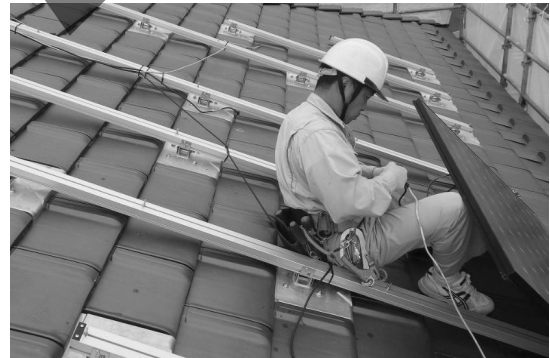
屋根置き設置型(傾斜瓦屋根)
