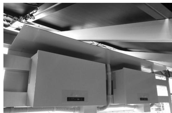
屋外用、架台下設置例
