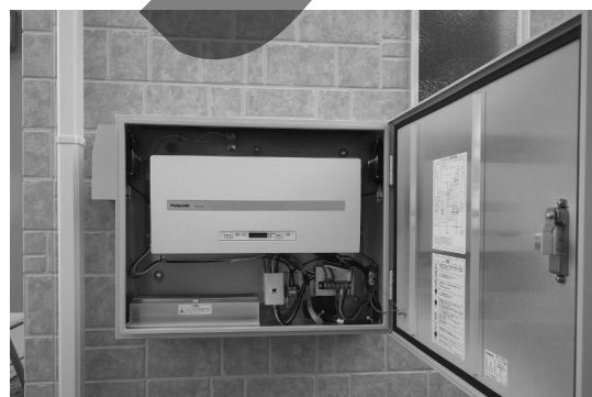
屋内用、屋外収納盤使用例
