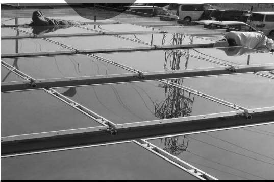
屋根置き平面設置型(折半屋根)
