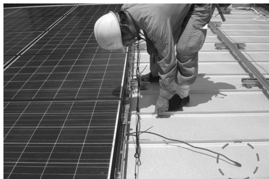
コネクタ踏みつけ破損の危険性
