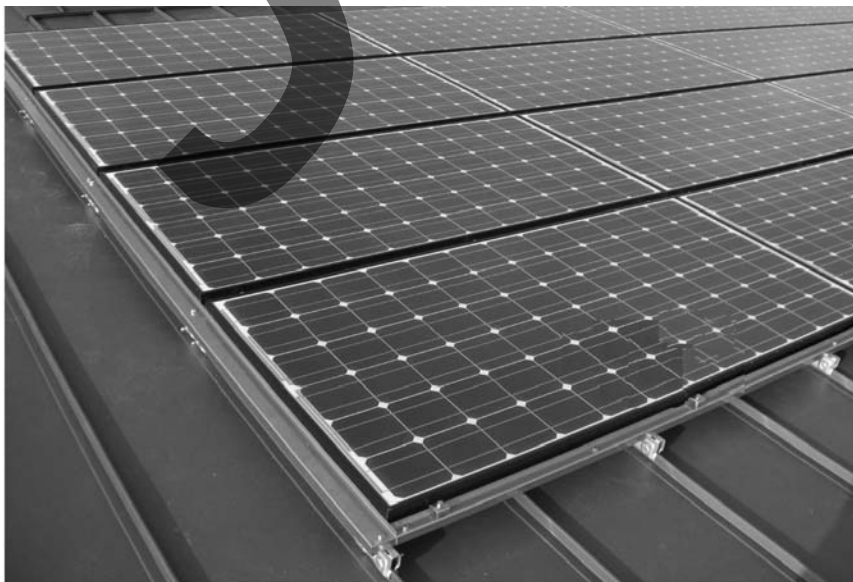
立平葺金属屋根に 施工されたPV
