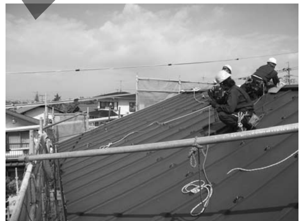
追加安全対策例②
