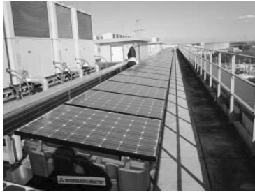
PVパネル（実験棟屋上）
