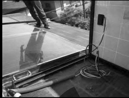
電線接続点の絶縁強度不足
